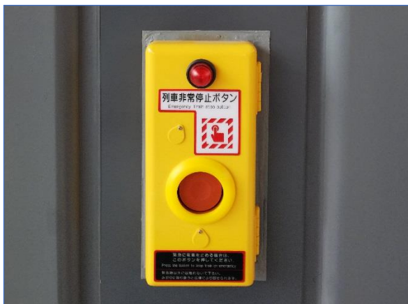
[列車非常停止通報ボタン]
