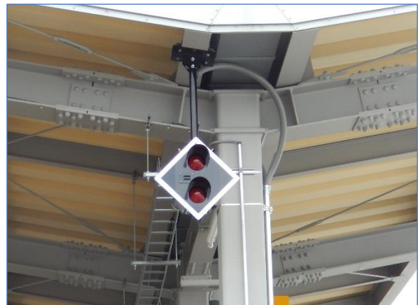
[列車非常停止警報機]
