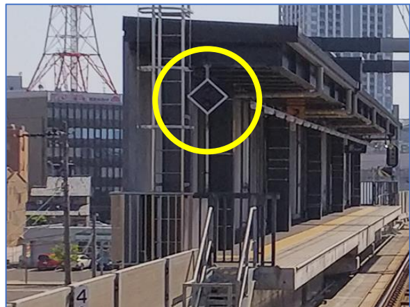
[列車非常停止警報機]
